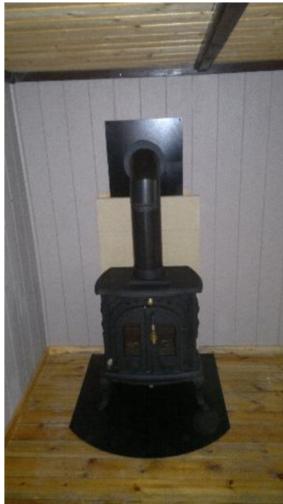
Ovan: Ask nyinstallerad i stuga. Nordic Heatings brandskyddsskivor är använda bakom kaminen för att minska avståndet till brännbart. Dessa skivor kan sedan målas, kläs i kakel etc.
